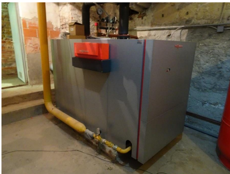
Slika 5.1: Vgrajen kotel Viessmann, Vitocrossal 200, nazivna toplotna moč 400 kW.
