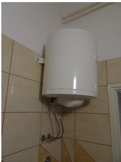
Slika 5.11: Bojler v sanitarijah volumna 50 litrov.
