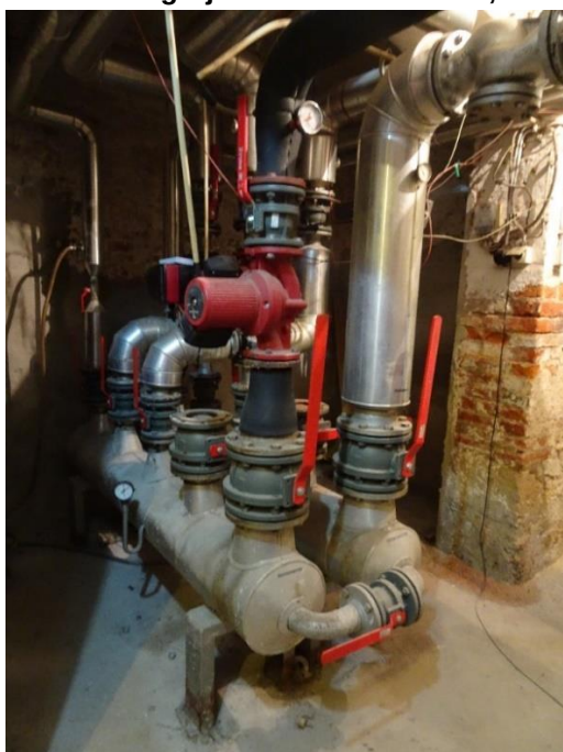
Slika 5.2: Toplotni razdelilnik v kotlovnici z ogrevalnimi vejami.
