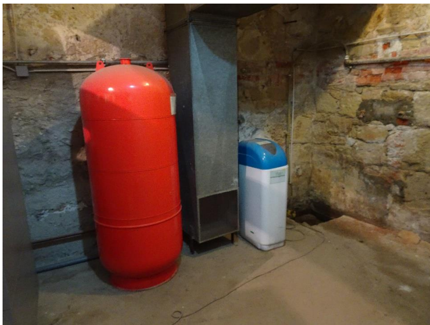
Slika 5.3: Raztezna posoda, mehčalna naprava in dovod zraka v kotlovnico.
