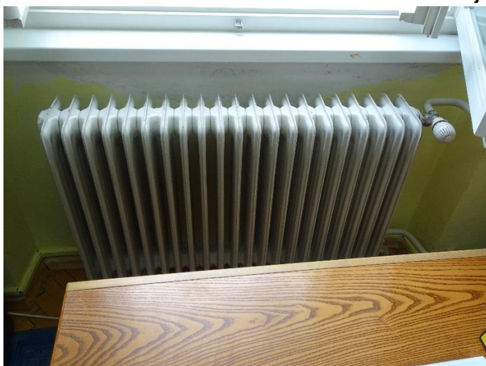
Slika 5.8: Radiator v 1. nadstropju – TRIKA jeklene izvedbe.
